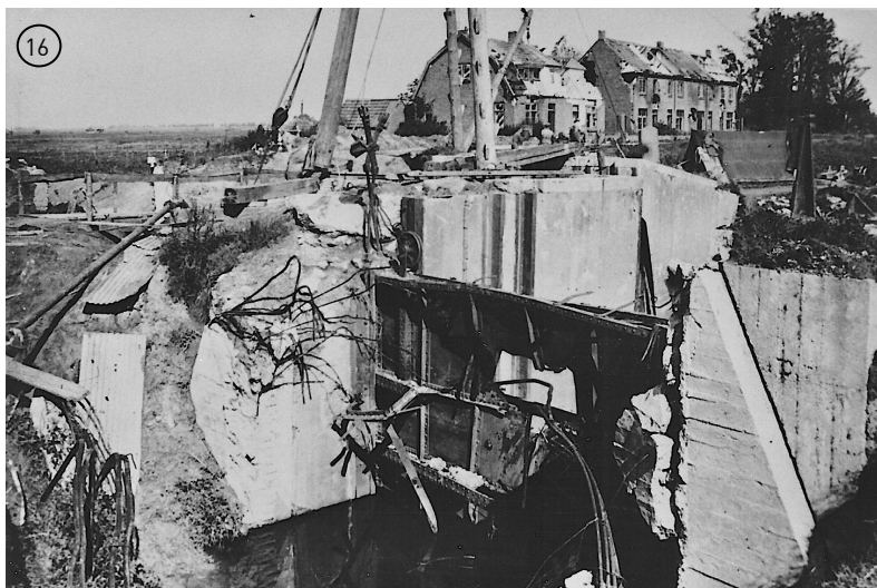
De opgeblazen brug en inlaatsluis bij de Bossche Sloot
